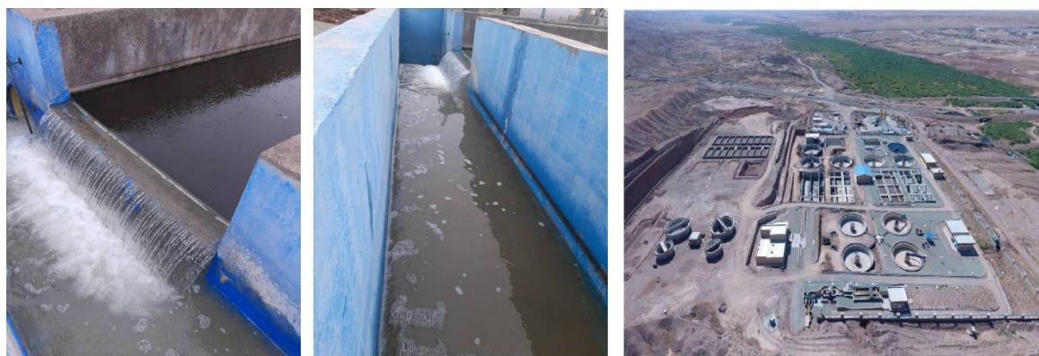
شکل ۲: تصاویری از نمای کلی تصفیه خانه و خروجی واحد بیولوژیکی
